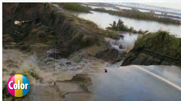
10時28分頃 堤防は未曽有の洪水に耐えきれず決壊(安八町大森)
