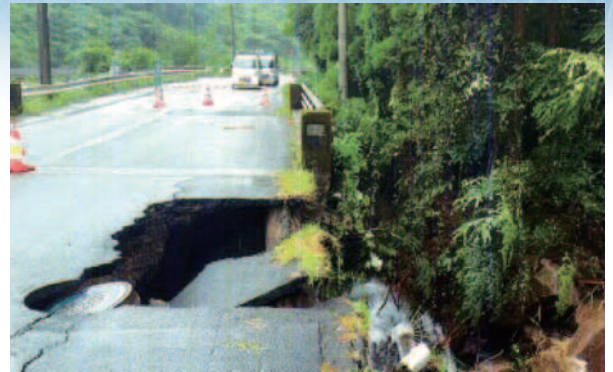
導水管(水管橋)破損(鹿児島県霧島市)
