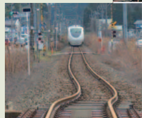
JR西日本七尾線 七尾駅～和倉温泉駅間の橋梁損傷 出典：国土交通省
