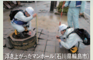
浮き上がったマンホール(石川県輪島市) 国土交通省 TEC-FORCE撮影
