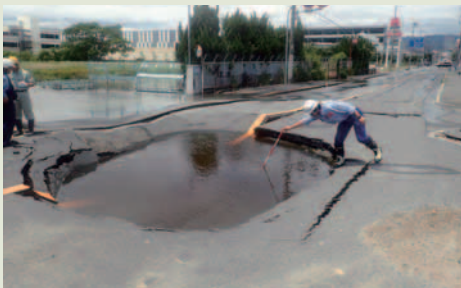
高槻市の道路陥没
