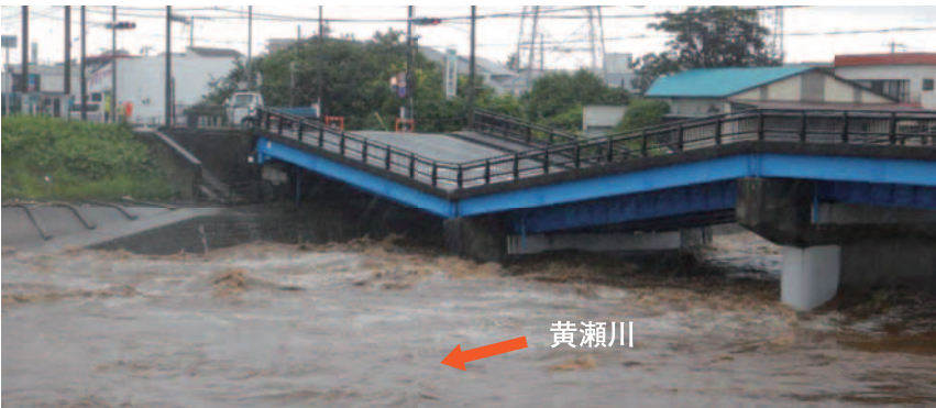
黄瀬川大橋橋脚、橋梁の損傷
