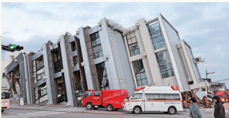
倒壊したビル(輪島市) 提供：北國新聞社
