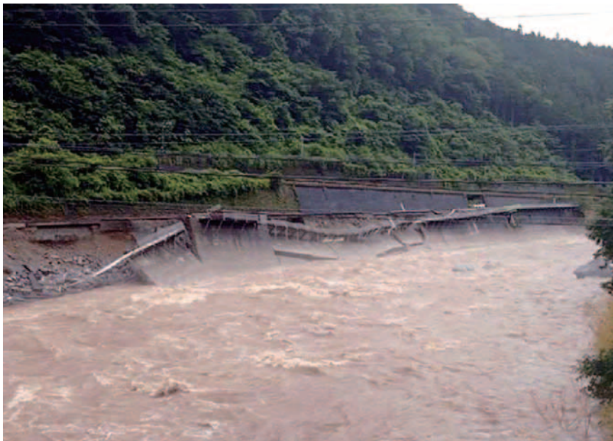
国道41号の道路崩壊(下呂市小坂町門坂)
