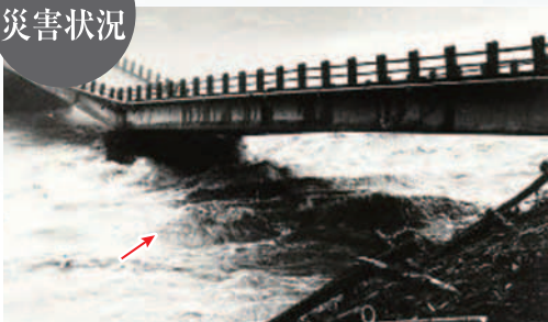
板取川・上野睦橋の落橋(美濃市) 提供:岐阜県
