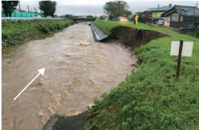
三渡川水系堀坂川(松阪市田牧町)の堤防洗掘 出典：国土交通省 中部地方整備局 河川部
