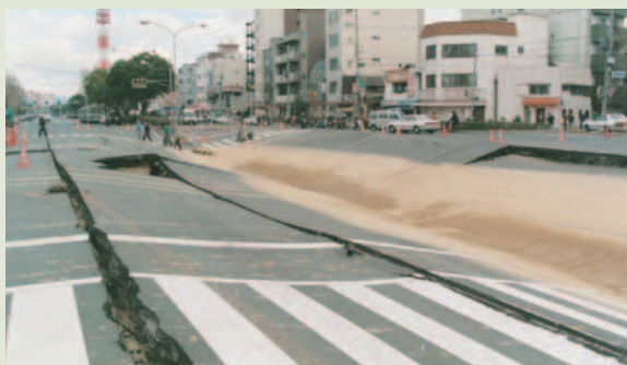
道路の陥没(兵庫区大開通) 提供:神戸市
