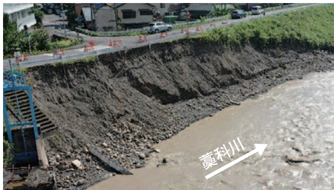
藁科川の被災状況 出典：国土交通省 中部地方整備局 河川部
