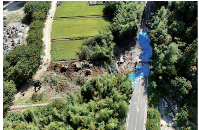
国道249号(石川県七尾市)道路崩落
