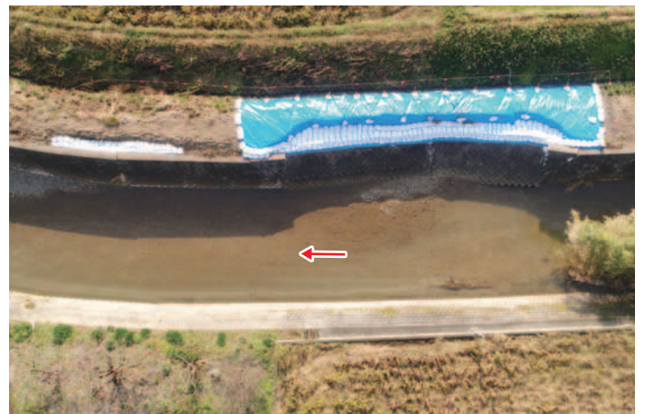
櫛田川水系佐奈川右岸5.0k付近 護岸欠損応急対策状況(多気郡多気町五柱)
