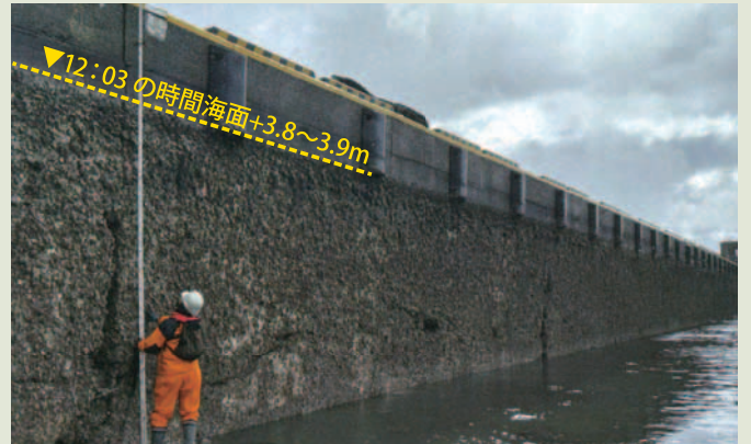
4m近い隆起が確認された鹿磯漁港の防潮堤(石川県輪島市) 鹿磯漁港の防潮堤に固着した生物遺骸が示す隆起の様子 出典：産業技術総合研究所地質調査総合センター
