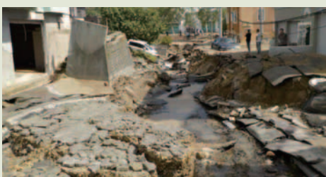
札幌市の液状化による被害
