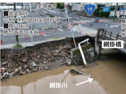
国道10号網掛橋上流側(左岸)の橋台背面の洗掘(鹿児島県始良市) 出典：国土交通省 九州地方整備局
