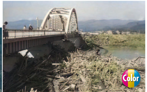
千歳橋に堆積した流木(静岡県田方郡菰山町南条) 白黒写真提供：国土交通省 中部地方整備局 沼津河川国道事務所
