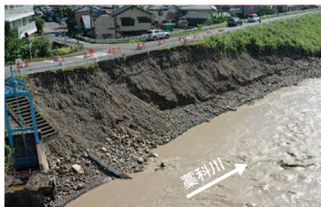
藁科川の被災状況
