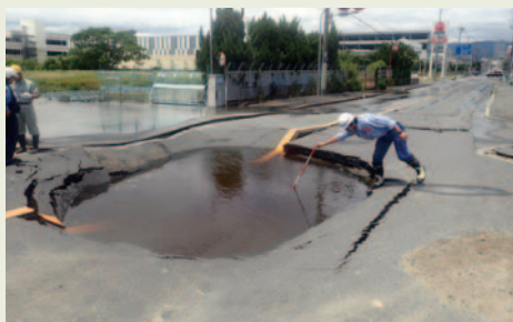
高槻市の道路陥没
