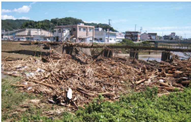
井戸川(熊野市)での被災状況 JR橋梁の損傷
