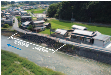
土岐川（瑞浪市釜戸町地内）の路肩崩壊 出典：国土交通省 中部地方整備局 河川部
