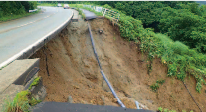
国道47号道路崩壊(山形県舟形町長尾地区) 出典：国土交通省 東北地方整備局 道路部
