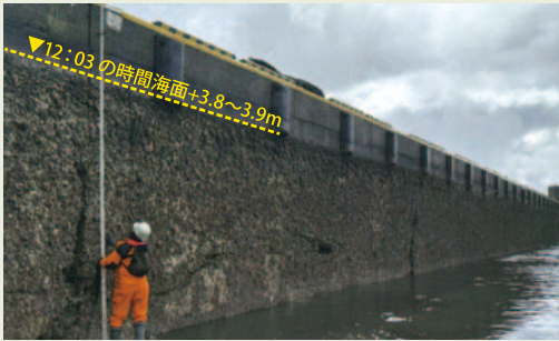
4m近い隆起が確認された鹿磯漁港の防潮堤（石川県輪島市） 鹿磯漁港の防潮堤に固着した生物遺骸が示す隆起の様子
