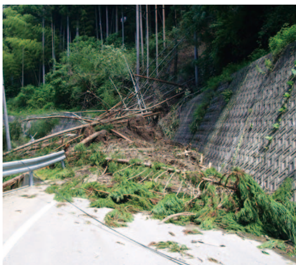
土砂崩れにより道路の寸断が発生 町道大平・小洞線（八百津町久田見・大平公園付近）
