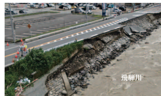
国道41号(岐阜県下呂市萩原)被災状況
