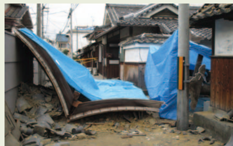
寺院の屋根崩壊
