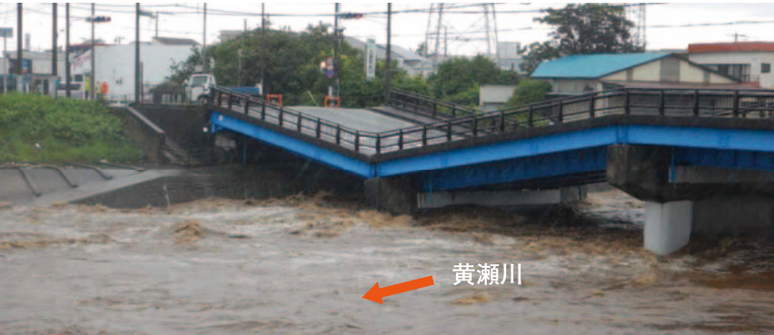
黄瀬川大橋橋脚、橋梁の損傷 出典:国土交通省 中部地方整備局 沼津河川国道事務所
