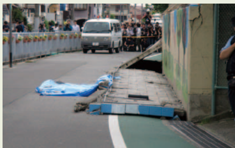
小学校のブロック塀倒壊
