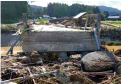
水道管破損(石川県珠洲市若山町) 出典:国土交通省 水管理・国土保全局
